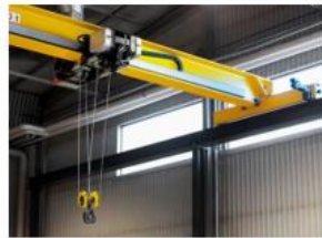
d. Hoist Crane
